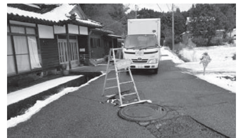
▲住宅へ続く細い道では、陥没やマンホールの突き出しが多くありました。
